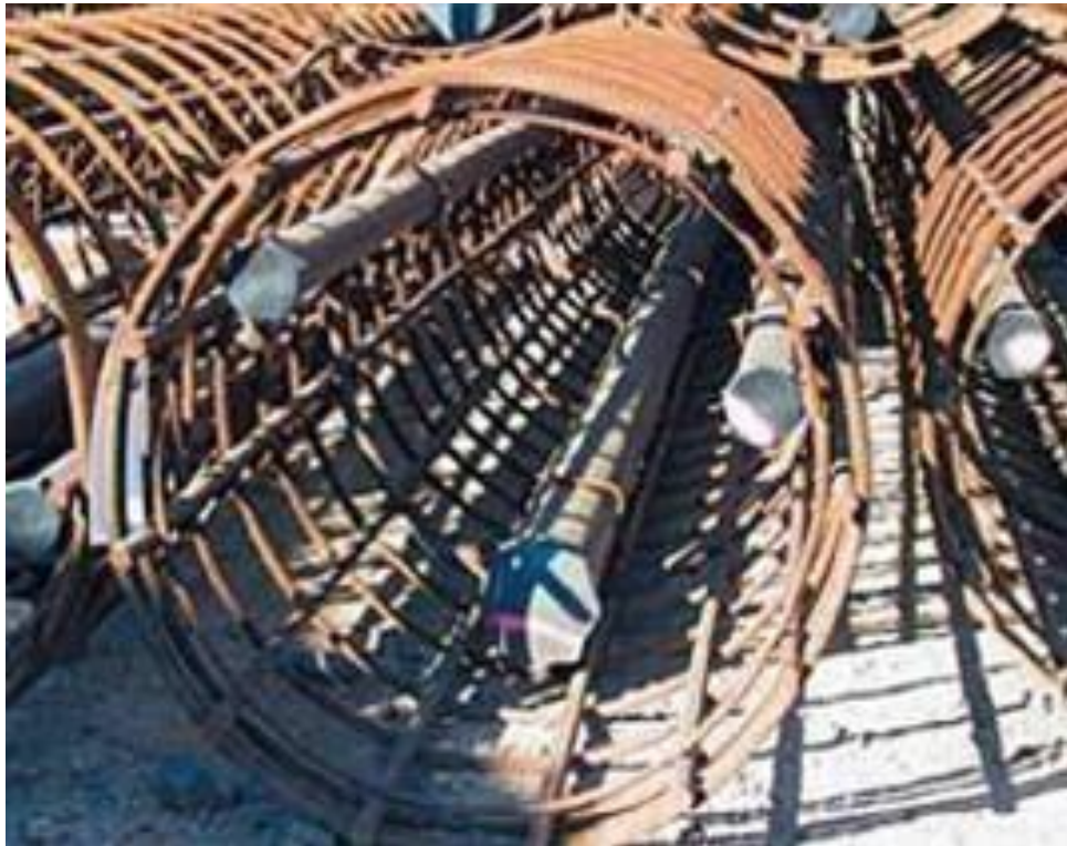
FIGURE 3.16 – Tubes de réservation mal positionnés .
