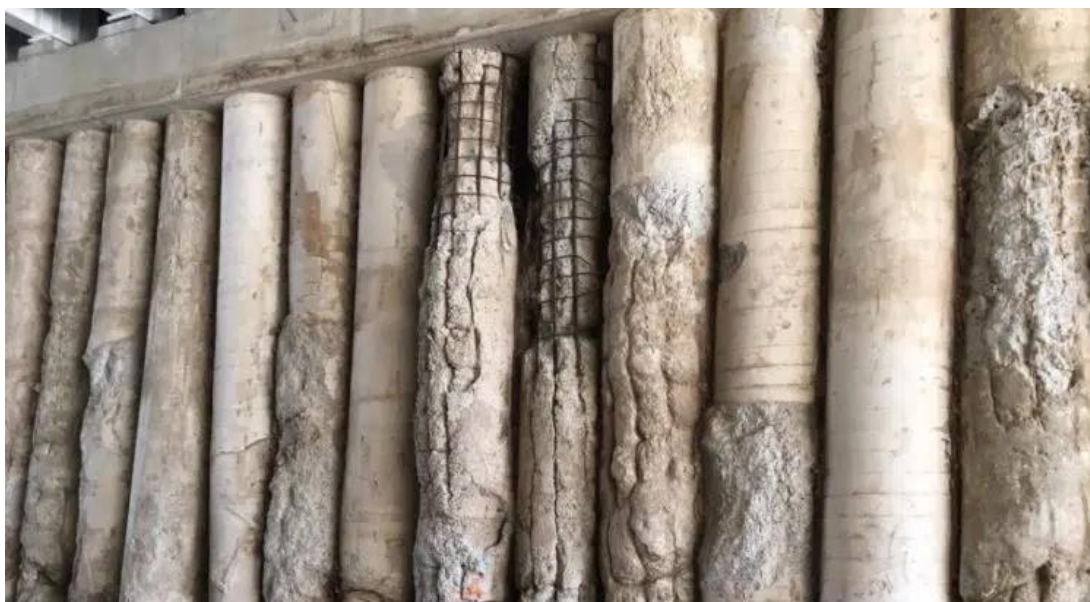
FIGURE 2.1 – Défaillances des pieux coulés in situ.
