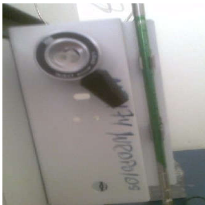
Figure 27: Photo personnelle; vanne d'injection fermée
